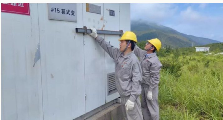
龙源浙江公司苍南鹤顶山风电场员工提前对户外箱变加装固定横杆
